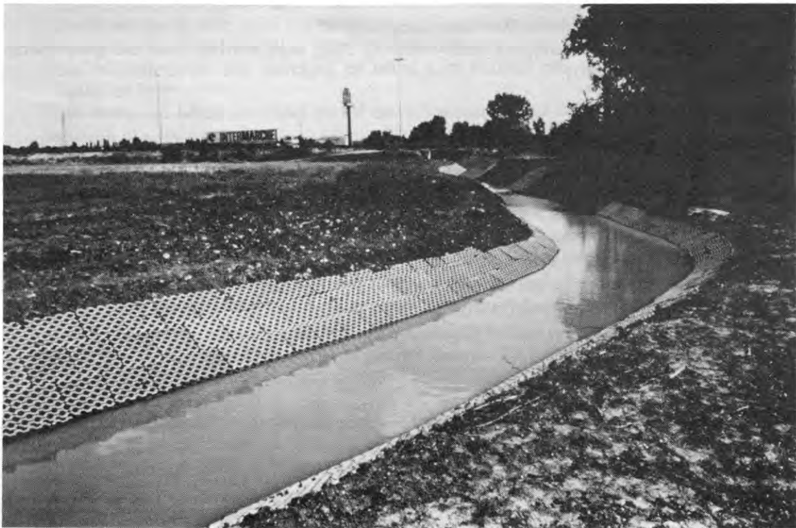
Vue d'ensemble d'un des ruisseaux étanché par une géomembrane bitumineuse / General view of one of the ditches waterproofed with a bituminous geomembrane
