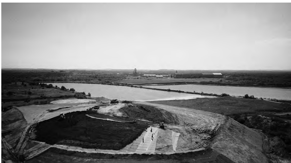
Photo 1 Vue générale du site avec différentes phases du chantier : préparation du support, géotextile, géomembrane, recouvrement en terre / Overview of the site with different phases of the work: preparation of the support, geotextile, geomembrane, covering soil.
