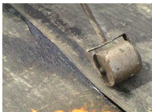
ncolado : desborde de bitumen
