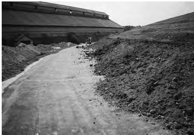
Photo 6 Couverture par terre directement sur la membrane bitumineuse / Capping by ground directly on the bituminous membrane.
